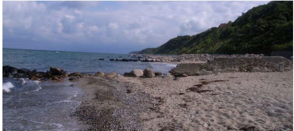
Figur 7-44 Nedslidte høfder ved Tisvilde, 2009
