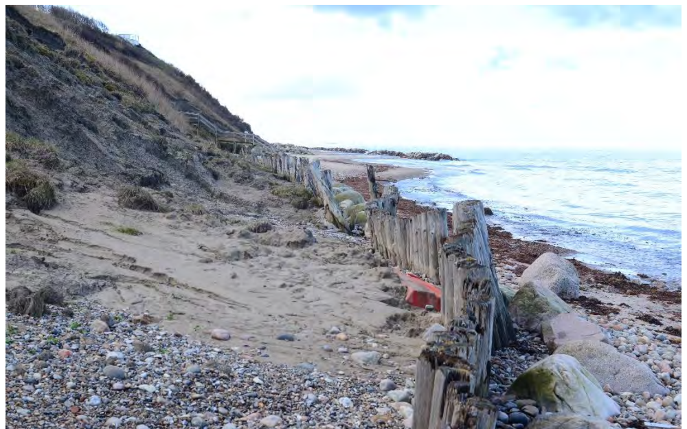
Figur 7-49 Nedslidt og uvirksom skråningsbeskyttelse ved Kaprifolievej, 2016
