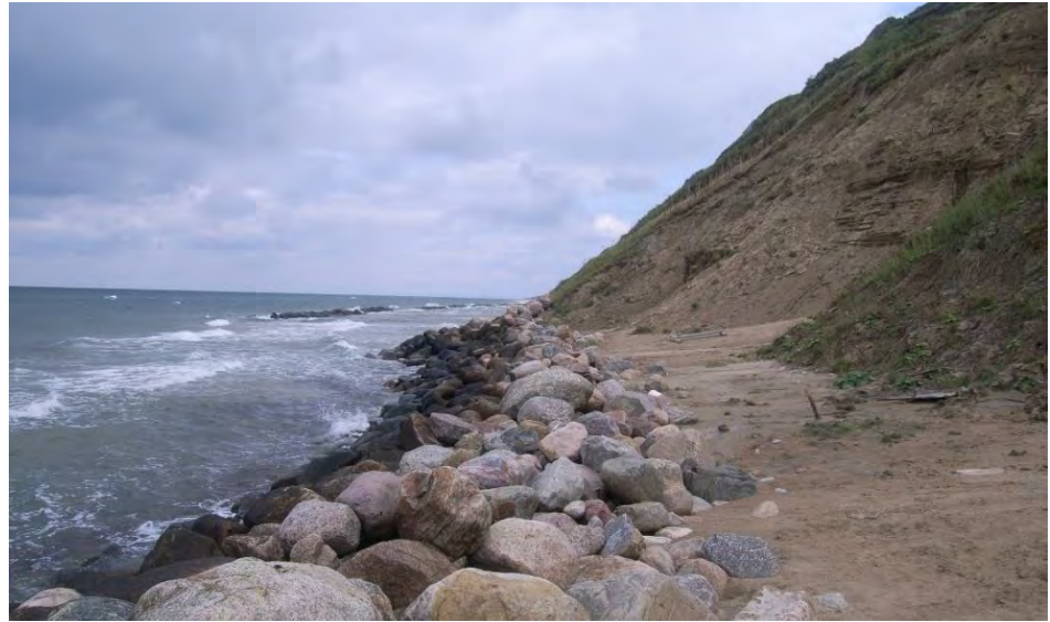
Figur 7-52 Stranden ved Svalevej er eroderet bort og skråningen er under kraftig erosion på trods af skråningsbeskyttelse, 2009
