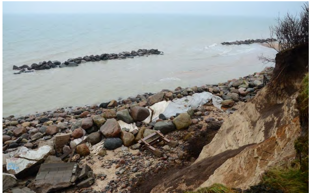
Figur 7-56 Adgangsvej til stranden ved Markvænget blev beskadiget af stormen Bodil
