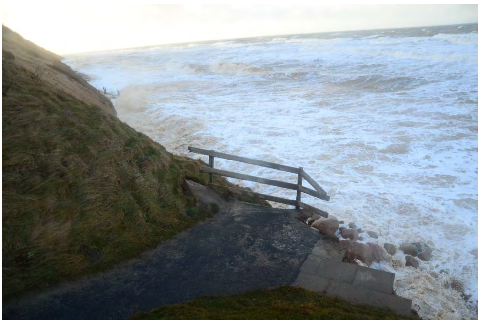
Figur 7-55 Adgangsvej til stranden ved Markvænget blev beskadiget af stormen Bodil
